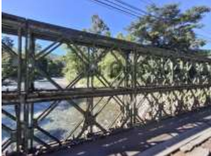
22 Fotografía No4. Vista interna de los paneles.
